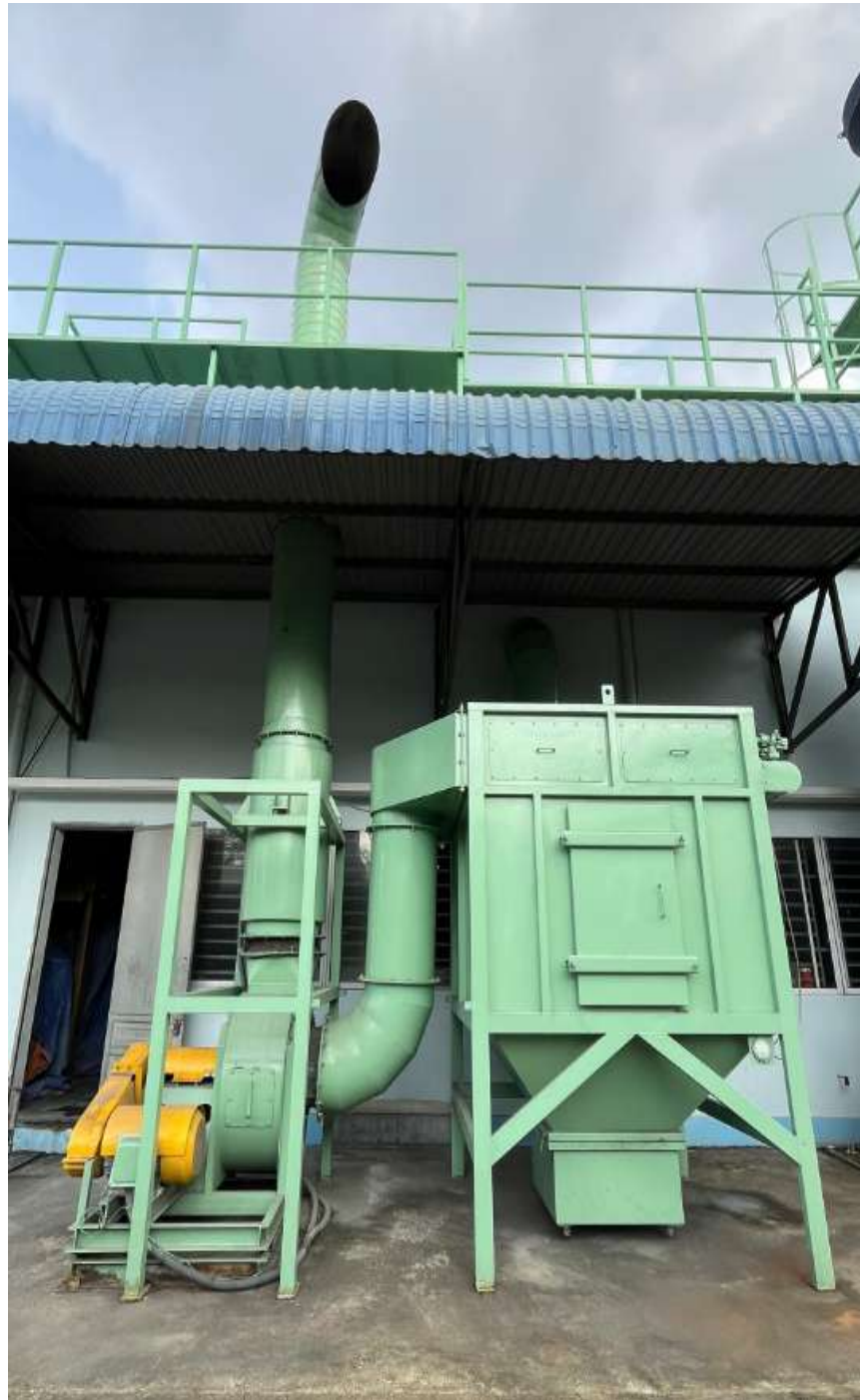
Hình 3.18. HTXL bụi sơn từ công đoạn sơn tĩnh điện
