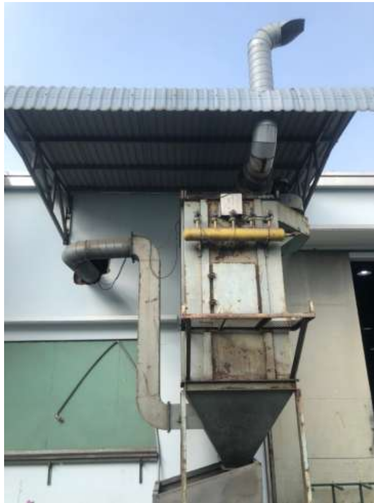
Hình 3.22. HTXL bụi mài nhôm (xưởng 2)
